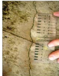
Figure 3 : Mesure de fissure
