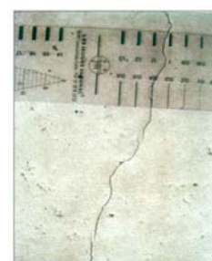
Figure 4 : Mesure de fissure
